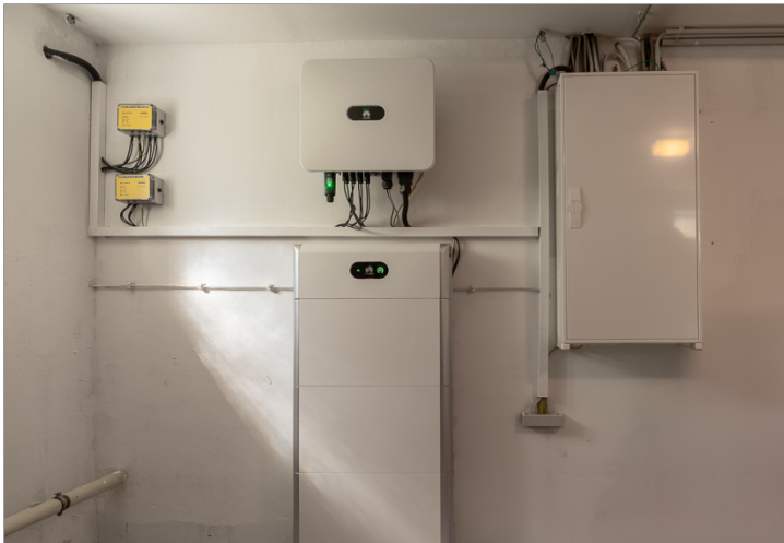
PV Speicher 15 KW
